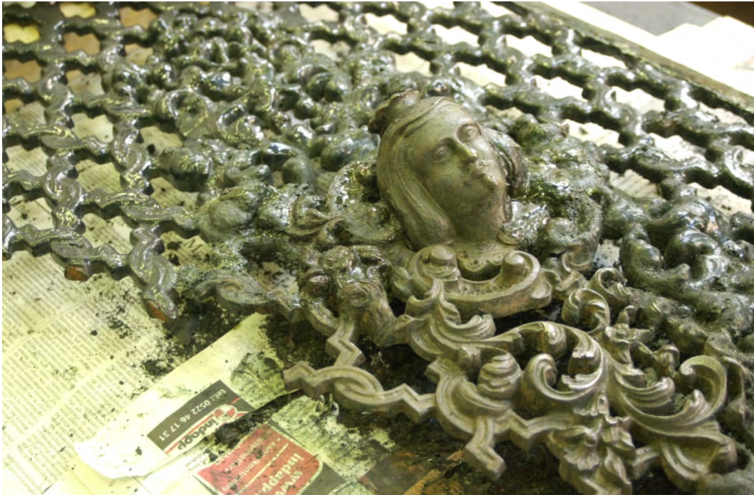
Afb. 7 Gietijzeren deurraam – de ramen waren dichtgeslibd door vele lagen verf, één was bovendien gebroken
