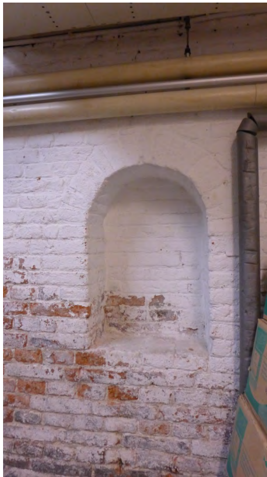
Afb. 29 Kaarsnis bij dubbele buitendeur met moderne latex verf
