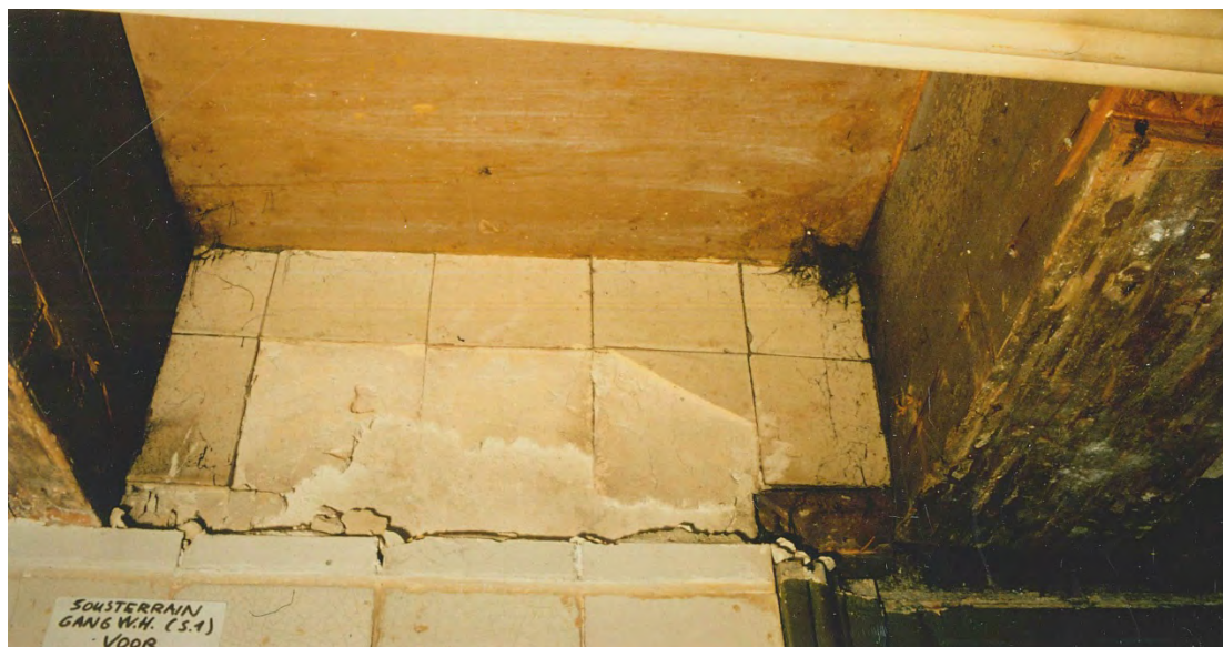
Afb. 17 Het voorste deel van de gang met oude tegelrestanten boven het moderne plafond, goed zichtbaar is hoe oude betegeling (boven) niet in lijn ligt met nieuw werk (onder).
